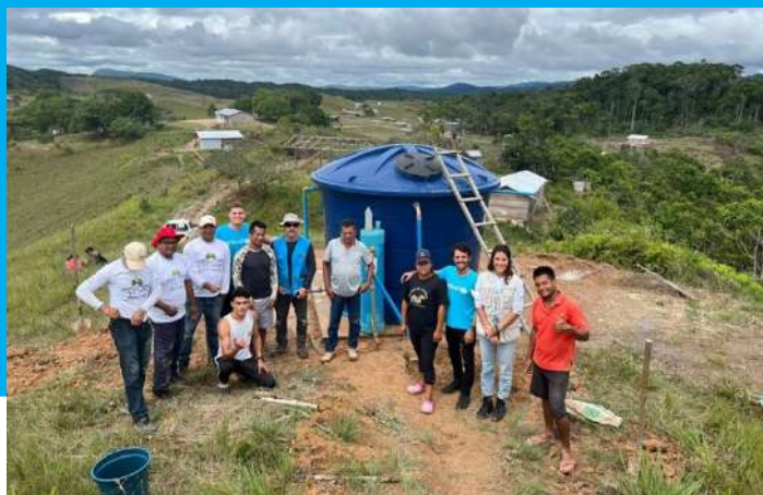
Sistema de tratamento e distribuição de água potável na comunidade Sakao-Mota da terra indígena São Marcos, em parceria com o CIR e DSEI-L/RR, Pacaraima/RR – janeiro, 2023.
